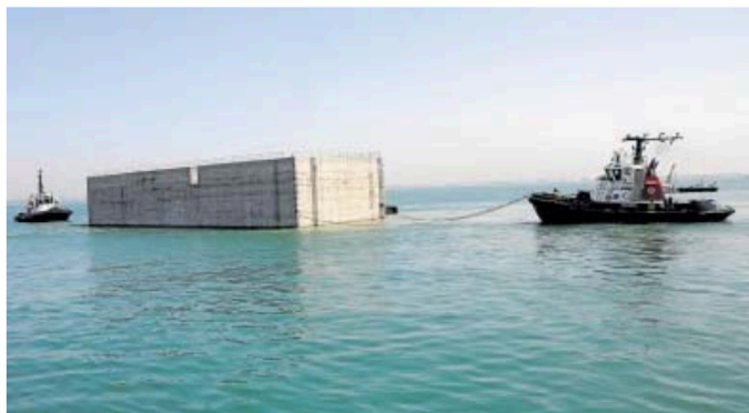
Los cajones que amplían la nueva terminal de contenedores del Puerto de Cádiz han sido fabricados con un hormigón de baja huella de carbono // HOLCIM
